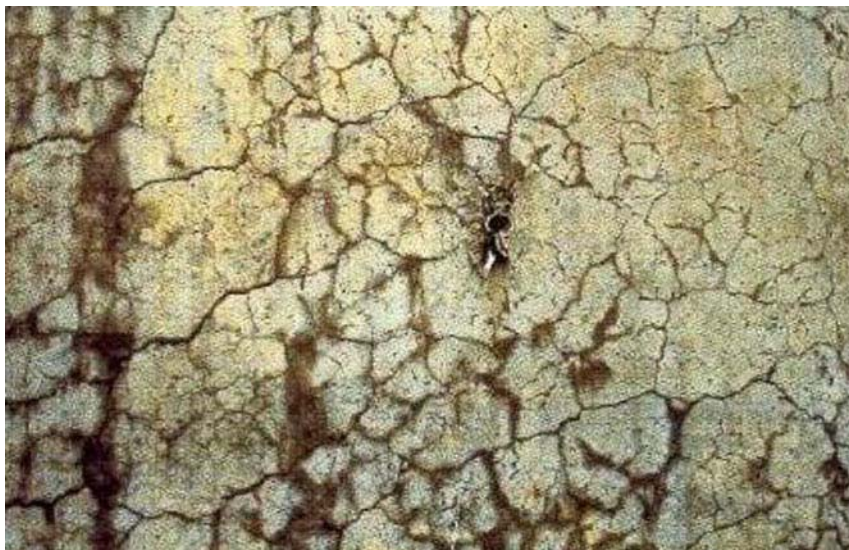
Exemple de faïençage souligné par la corrosion
