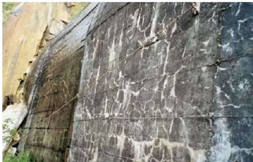
Mur d'entrée d'un tunnel atteint d'une réaction alcali-granulat
