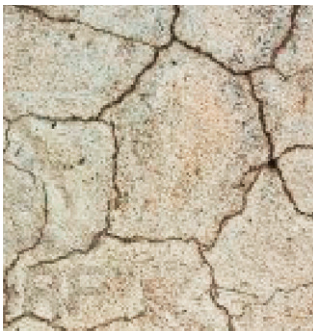
Exemple de faïençage du béton attaqué par la RAG.
