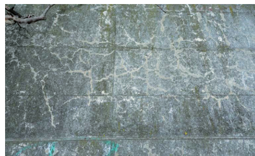
La RAG attaque le béton, dont la détérioration entraîne celle des fers à béton. Toute la structure est donc mise à mal.
